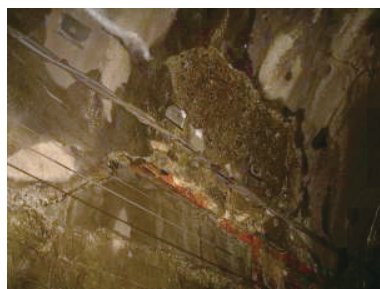
Photo. 2 吹付けモルタルはく落
