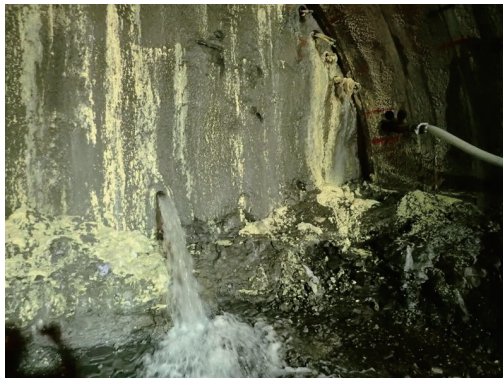
Photo. 3 調査ボーリング孔からの湧水状況
