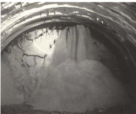
Photo. 1 NATM区間における切羽崩落状況
