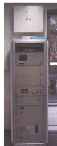
制御盤・観測システム
