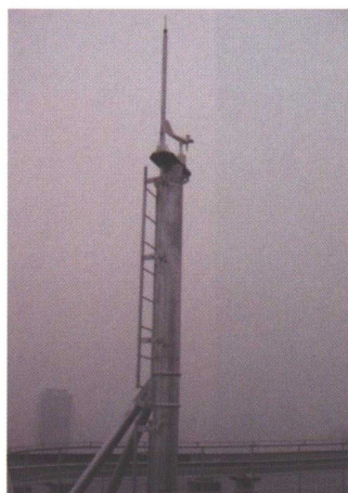
風向風速計(屋上)
