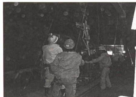
Photo. 2 荷揚げ用架台
