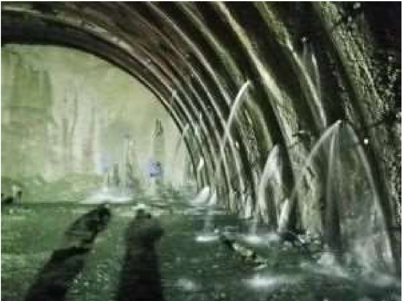
写真2 トンネル掘削後の壁面からの湧水状況
