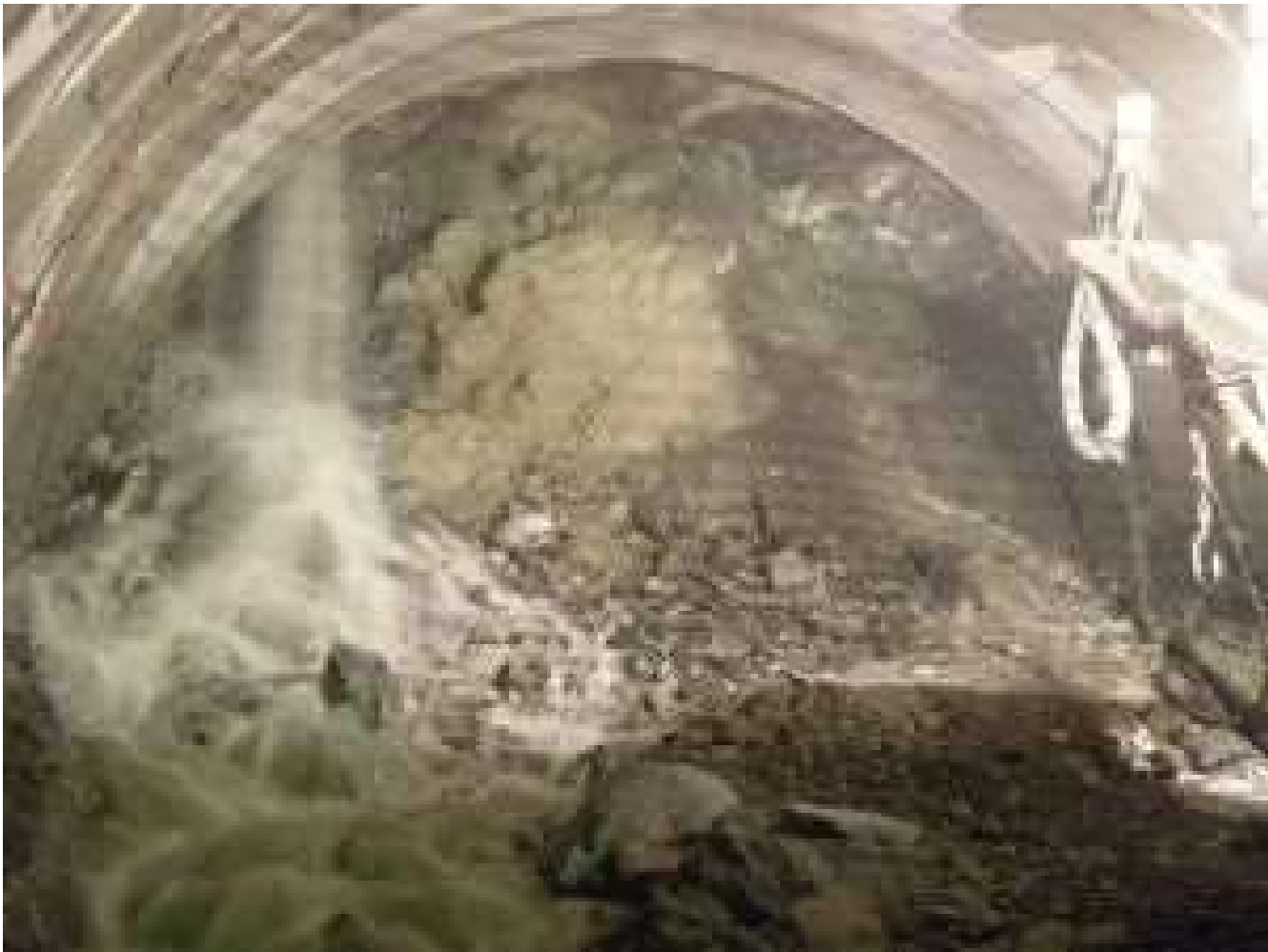
写真 1 低速度帯付近の掘削時の大量湧水状況
