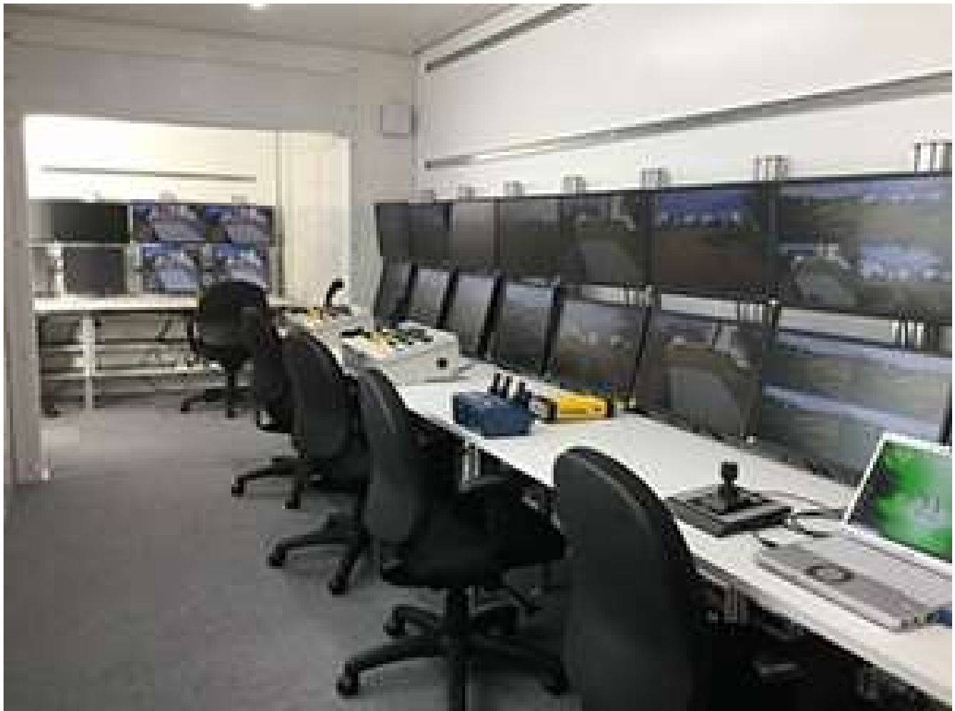
操作室内部設備
