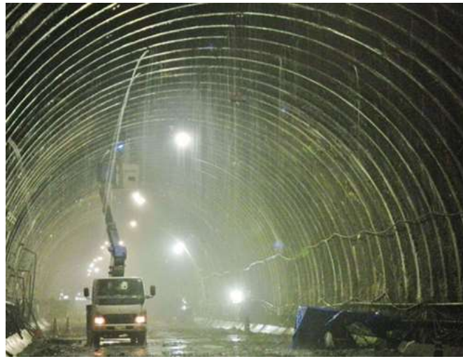
写真-1 北薩トンネル減水対策工施工前の湧水状況
