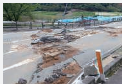
熊本地震による旧堤体の亀裂
