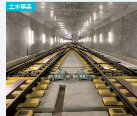
土木事業 銀座線浅草駅 折返し線延伸に伴う土木工事 浅草変電所 (仮称) 新設建築・土木工事 (東京都) 発注者: 東京地下鉄 (株)
