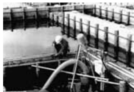
最終沈殿池(溜池)から河川に放流する前に、水質を測定しています。
