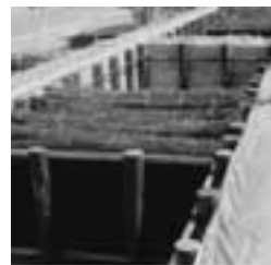
自然の素材である竹の束(竹そだ)を用いて、土などによる濁りを取り除きます。(竹そだ柵る過自然沈降方式)
