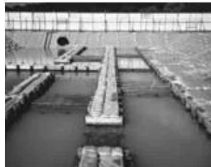
大雨の場合など、現場内に降った雨は土が混じって排水されます。従って、このような水は沈殿池(人工の溜池)に集めて、濁りなどを取り除きます。
