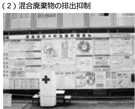
朝礼広場の掲示板 作業所では、社員、全作業員が毎日朝礼を行い、その日の注意事項などが伝達されます。この朝礼広場の掲示板には全ての作業員が認識できるように、建設廃棄物や混合廃棄物の削減目標と月次実績が掲示されています。
