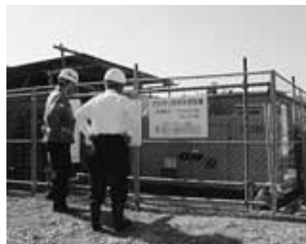
工場排水がコンクリート殻と接触して強アルカリ性となるため、沈砂池に中和処理プラントを設置しています。工事排水は全量、このプラントを通過して排出されるので、下流の河川に影響を与えません。
