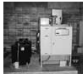
技術研究所の排水管理を行っている施設です。
