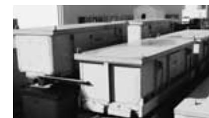
PCB廃棄物の保管状況です。鉄の箱に入れて保管しています。なお、保健所より塗装の一部について補修が必要との指導がありましたので、この補修を完了しています。
