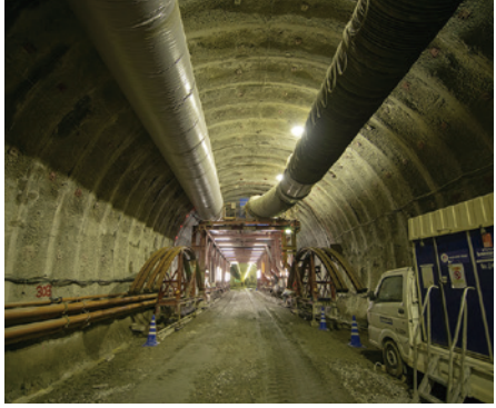
トンネル上部に設置された空気清浄のためのパイプ(右パイプでトンネル内の空気を吸い込み、左パイプで清浄した空気を送り返す)
