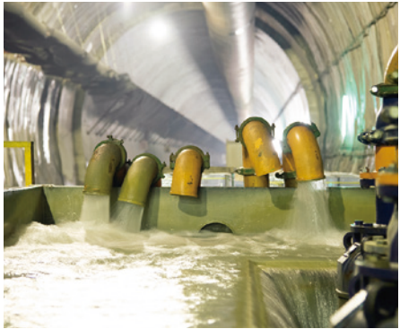
掘削に伴って発生した湧水を清濁に分離する処理設備
