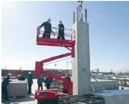
精度良く設置完了したPCa柱は、高所作業車を使用してクレーンのワイヤーロープを外す
