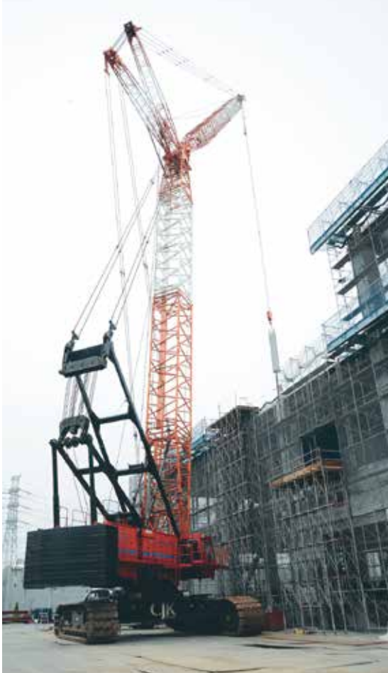
クレーンオペレーターと篤工は、無線とカメラを使用し、常に吊荷を監視
