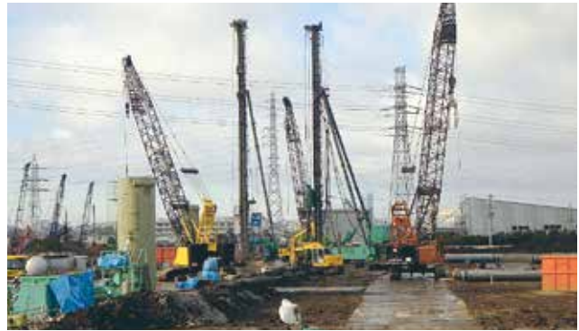
広大な敷地である為、2機の杭打機を同時施工させ工期短縮を図る(平成24.12.1)
