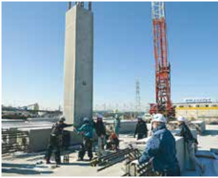
現場最初の工区では30本/日の柱を建てる為に前日に先行搬入を試みた連結される柱鉄筋の精度も良くスムーズに30本の柱を設置完了 以後、次工区からは当日搬入計画にて工事は進行
