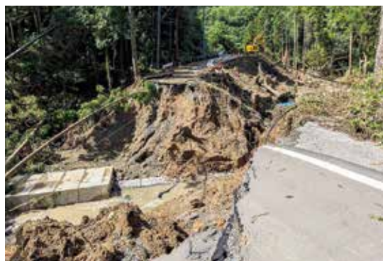
豪雨直後の国道249号・中屋トンネル東工区
