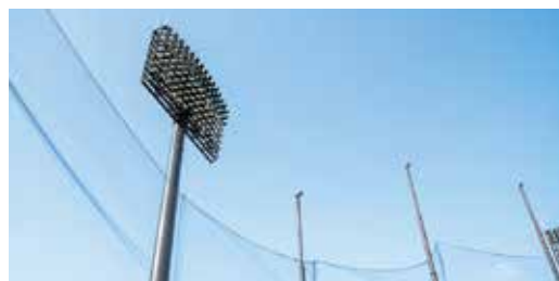
LEDナイター照明と高さ約50mのネット
