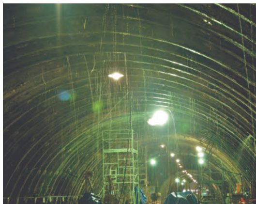
減水対策工前（作業時に雨合羽が必要）
