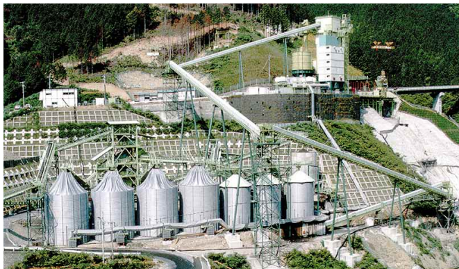
坂本ダムにおける細骨材および粗骨材気化冷却設備
