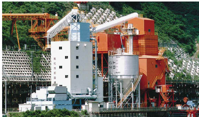
大滝ダムにおける細骨材気化冷却設備
