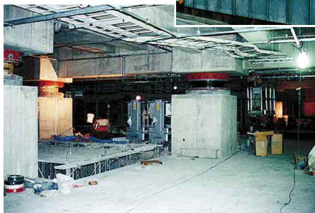
免震ピットを有効利用した地下階駐車場
