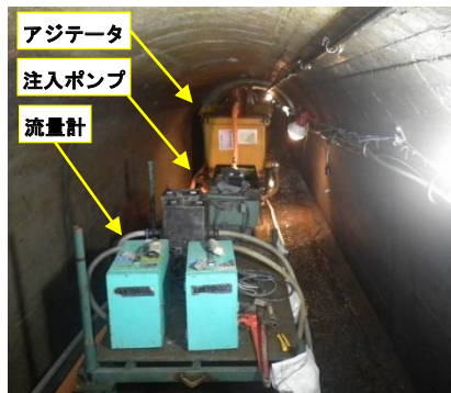
Photo. 9 二次プラント
