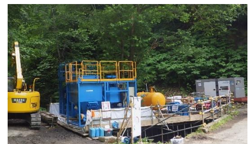
Photo. 8 一次プラント
