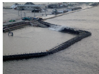
Photo. 8 仮締切内浸水状況 2016. 1. 19
