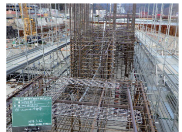
Photo. 16 クーリングパイプ配置
