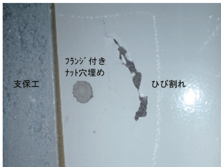
Photo. 1 ひび割れ発生状況
