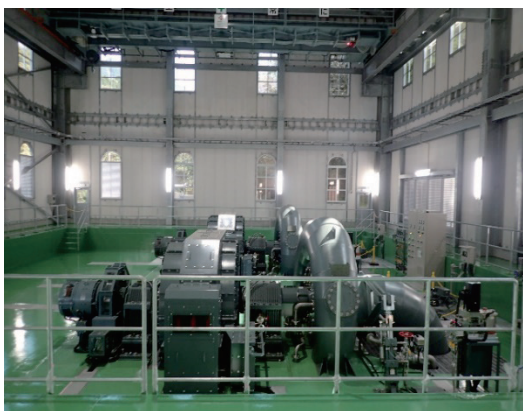
Photo. 5 新設水車発電機
