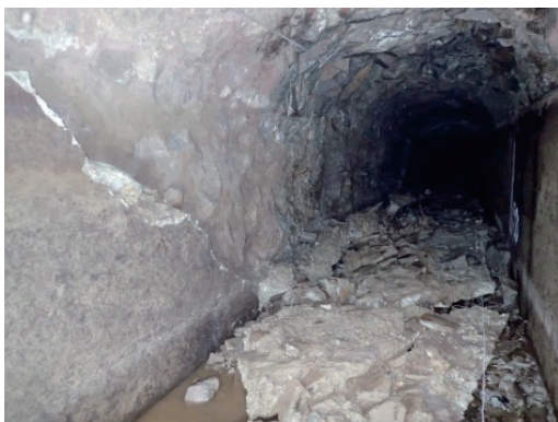
Photo. 16 側壁コンクリートの倒壊状況
