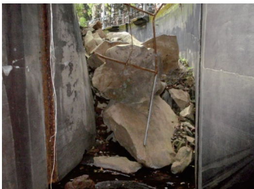
Photo. 6 斜面崩壊巨石による水槽の閉塞
