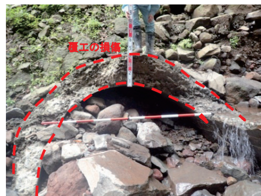
Photo. 13 損壊部 第2号隧道終点付近
