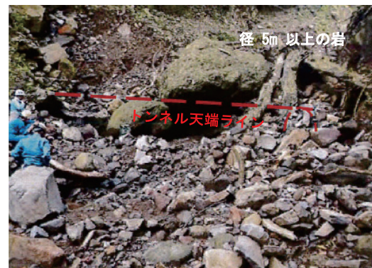
Photo. 12 損壊部 (地上に露出した導水路の状況)
