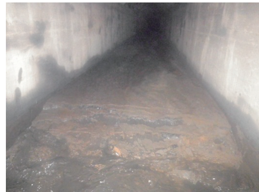
Photo. 11 堆積土砂状況
