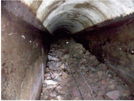
Photo. 14 落盤部（下流側の崩落状況）
