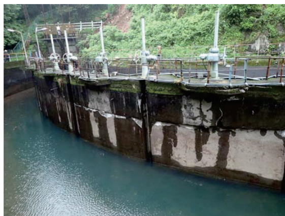
Photo. 8 水槽中央隔壁の損傷
