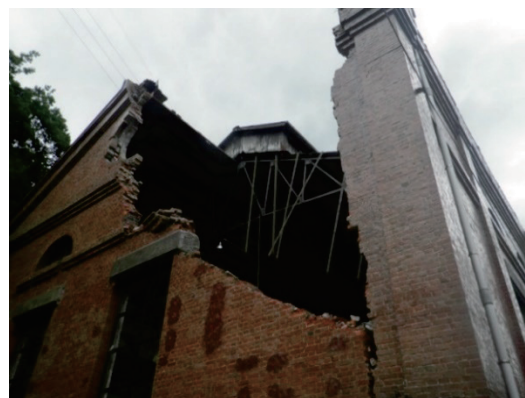
Photo. 2 地震による建屋損傷状況
