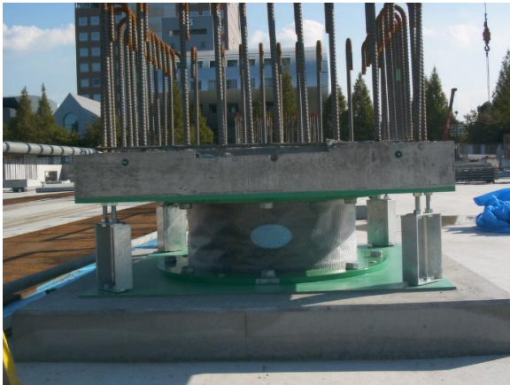
Photo. 8 C型鋼積層ゴム支承拘束状況
