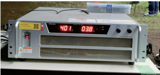
Photo. 12 AC/DC 400V 直流電源装置
