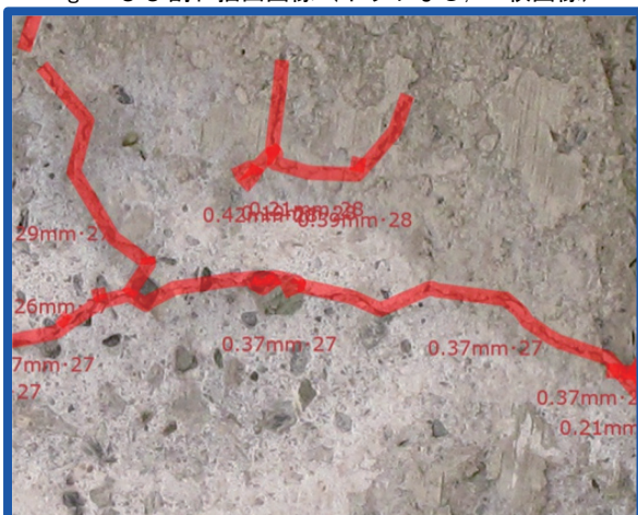
Fig. 7 ひび割れ抽出部拡大 (ネットなし, 青枠部)
