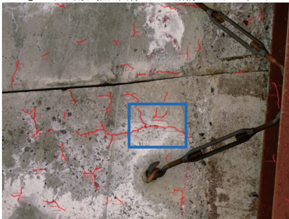
Fig. 6 ひび割れ抽出画像 (ネットなし, 1枚画像)
