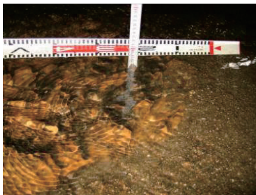
Photo. 3 インバートの洗掘状況
