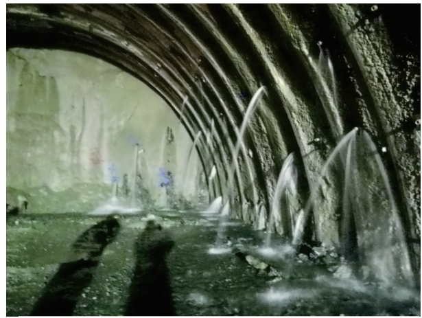
Photo. 2 トンネル掘進後の壁面からの湧水状況
