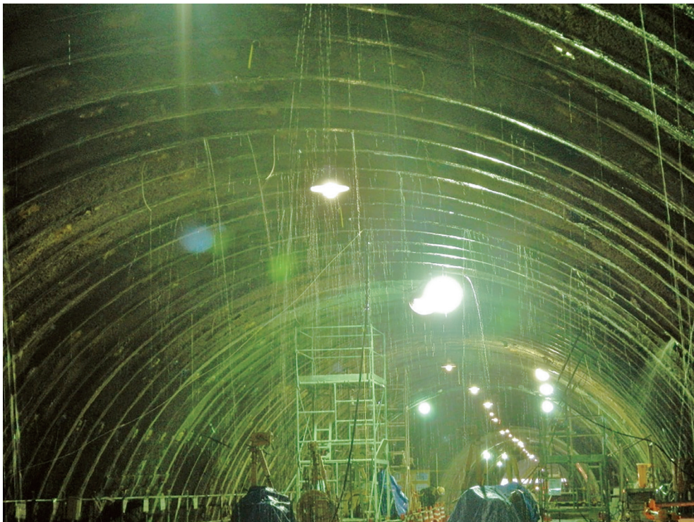
減水対策施工前
