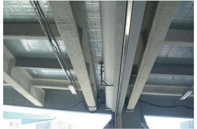
Photo. 21 シャッター取合梁状況
