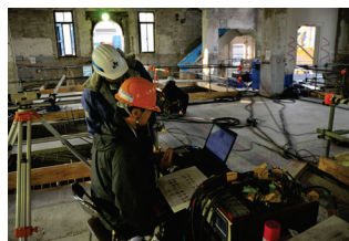
Photo. 10 パソコンによる管理状況
