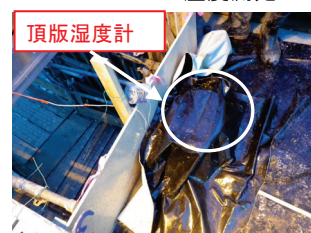
Photo. 36 頂版湿度測定
