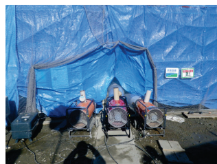
Photo. 29 ジェットファーンレス3台設置
