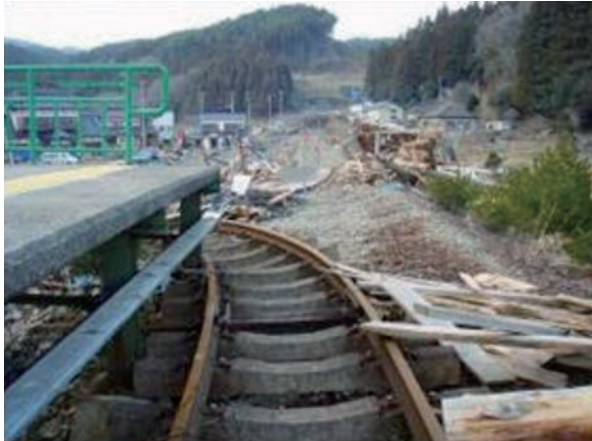
甫嶺地区被災状況
