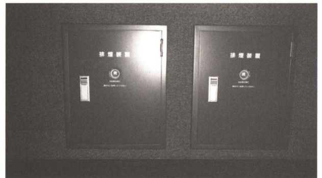
Photo. 2 排煙オペレーター操作面
