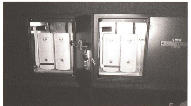
Photo. 3 排煙オペレーター内部
