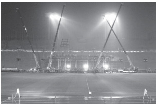
Photo. 22 鉄骨組立状況 屋根A型フレーム吊込 平成21年6月29日 23時頃
