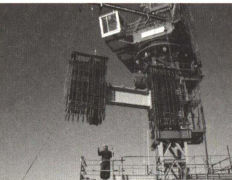
Photo. 11 TWユニット
