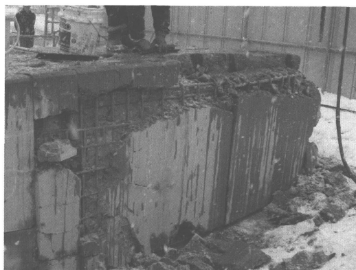
Photo. 13 表面破碎全体状況
