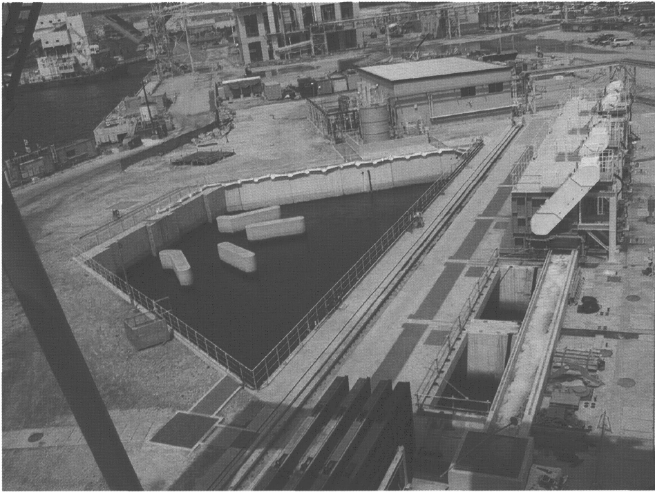
神鋼神戸発電所（石炭火力発電所：出力140万 kW）で試運転中の冷却水取水用海水ポンプピットの外観
