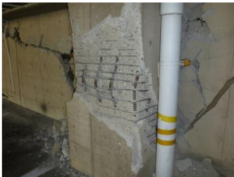
Photo. 1 熊本地震におけるピロティ柱の被害事例 1)
